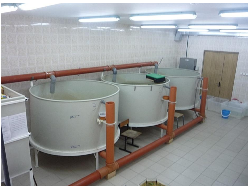
Установка замкнутого водоснабжения лаборатории перспективных технологий в аквакультуре (Бизнес-инкубатор КубГУ)
