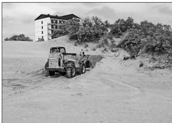
Рис. 2. Прокладка прорезей через дюны нарушает рельеф и растительный покров
