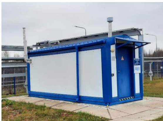
Рис. 1. Узел подогрева и дозирования
