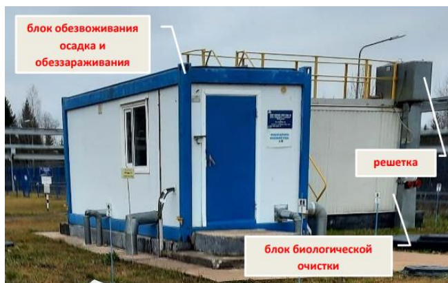
Рис. 2. Очистные сооружения биологической очистки «КСкомплект-I-36Ф»
