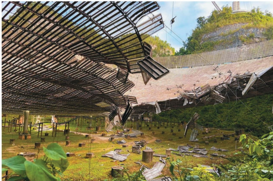
Повреждение зеркала телескопа после обрыва каната в августе 2020 года.
